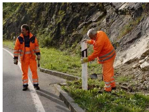
Austausch eines beschädigten Leitpfostens © Staatsbauverwaltung
